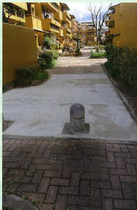
府営城東住宅自治会からの声で、住宅内の老朽化通路を補修しました。
